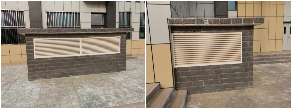
地下车库换气装置
