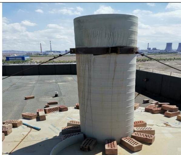
镍系统排气筒
