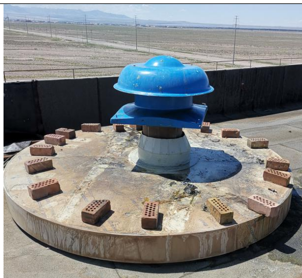
塑烧板除尘器排气筒
